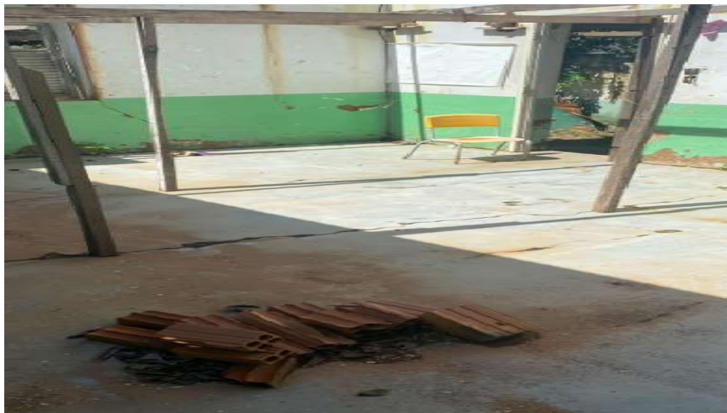
Sala 01 - Piso cimento queimado e porta deteriorada
